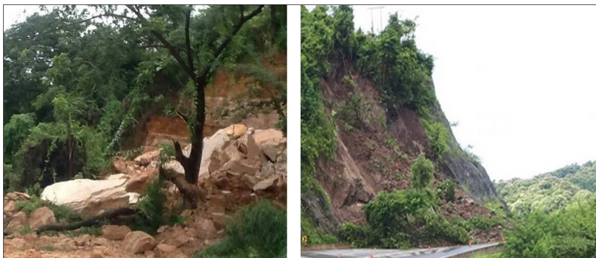
ภาพที่ ๔-๓๖ ดินถล่มบริเวณไหล่ถนน ทางหลวงหมายเลข ๑๒ พิษณุโลก-หล่มสัก ตำบลแคมป์สน อำเภอเขาค้อ จังหวัดเพชรบูรณ์
